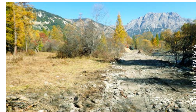
Travaux d'arasement de la digue afin de reconnecter le marais avec la Clarée
