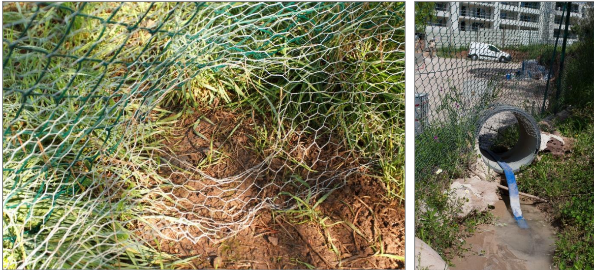
Exemples de grillages perméables à la petite faune en raison de dégradation ou de conception inadaptée © J. CELSE
