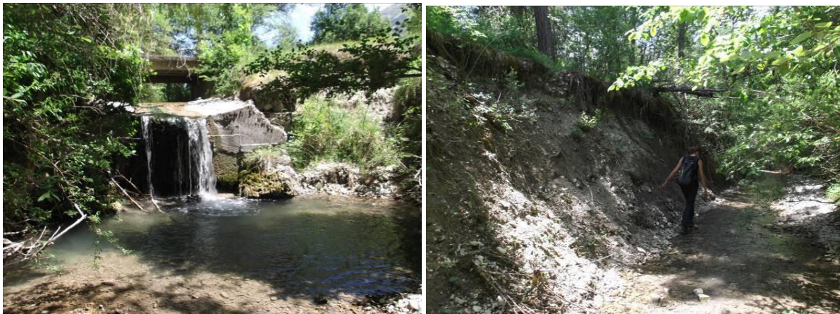
Figure 3 : Forte incision du lit du Riou Tort (berges perchées à 2-3 m)
