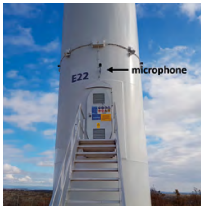
Microphone nécessaire à l'écoute des chiroptères positionné sur l'éolienne 22, Artigues-Ollières (83)
